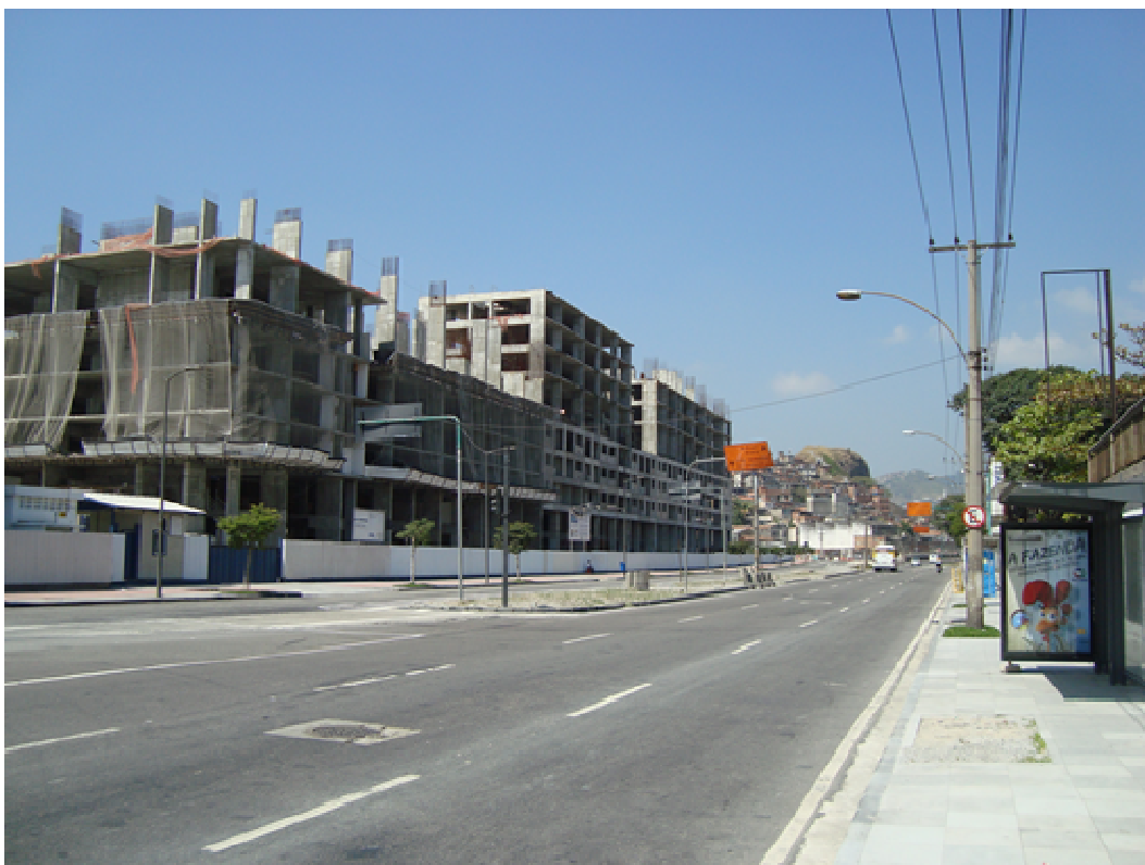
Figura 03 – O canteiro de obras do Porto Olímpico, paralisado por decisão do consórcio construtor em junho de 2014. Ao fundo, o vizinho Morro do Pinto. Foto do autor. Setembro de 2014.
